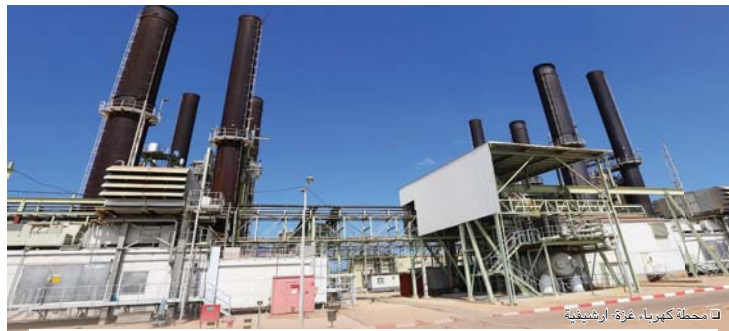
محطة كهرباء، غزة، أرشيفية
